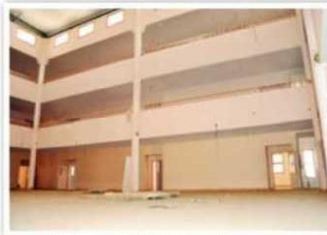
مبنى مدرسي من الداخل وقد ظهر عليه الإهمال وعمسة - عهد الغفر
