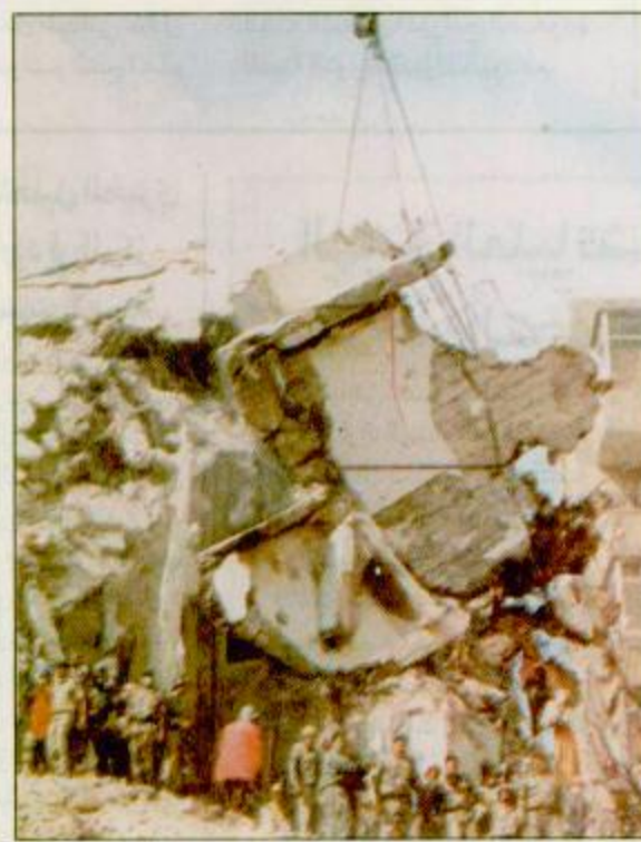
القاهرة - تواصل عمليات البحث عن جثث ضحايا عمارة مصر الجديدة
