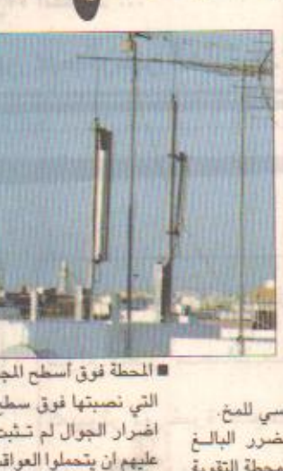
المحطة فوق سطح الجمع السكني (تصوير/ طارق الشعر) التي نصبتها فوق سطح الجمع وترد على سكان الجمع بأن أضرار الجوال لم تثبت علمياً. وحتى يتم إثباتها أو نفيها عليهم أن يتحملوا العواقب حتى ولو كانت الإصابة بالسرطان!
