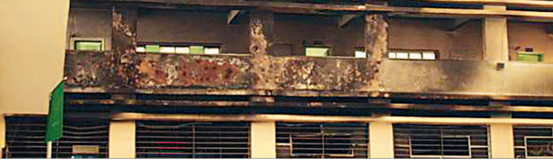
آثار الحريق على مدرسة خميس مشيط وفي الاطار مدير تعليم مكة الذي توفي امس تصوير: حسن آل سيد [ص٦٠]
