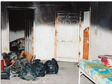
آثار الحريق بجداري غرف المنزل
