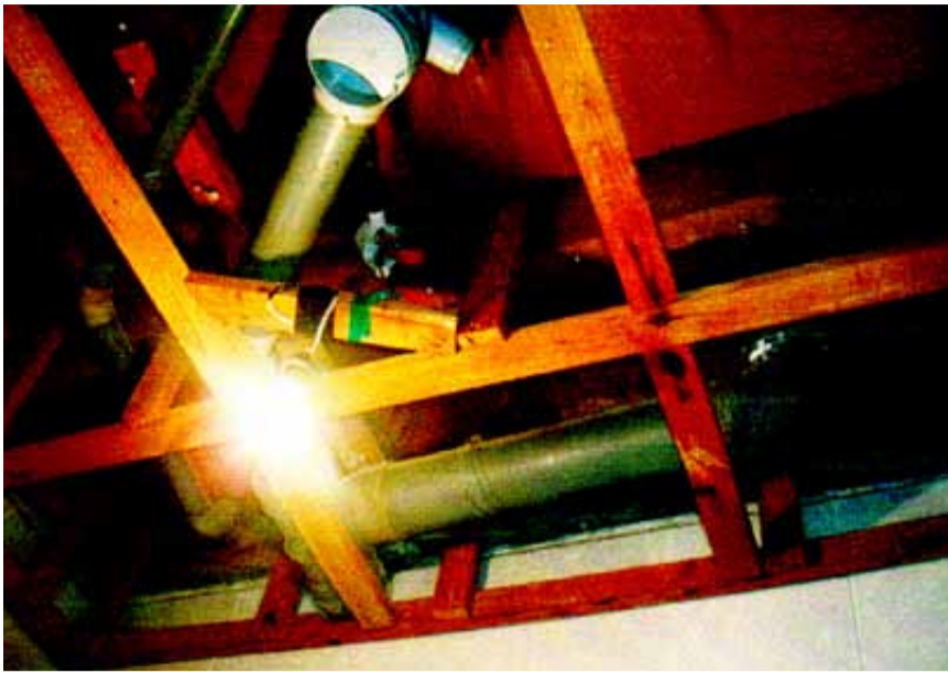
آثار الشروخ البائنة على جدران المنزل وكذلك السقف الخشبي الواضح للعيان سواء من الحمام أو غرفة المعيشة
