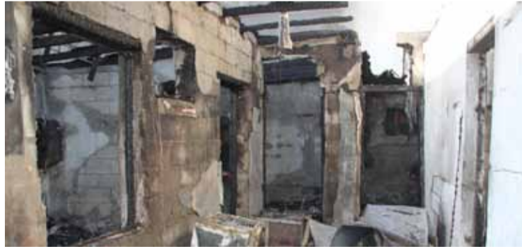
أثار الحريق في منزل العمال
