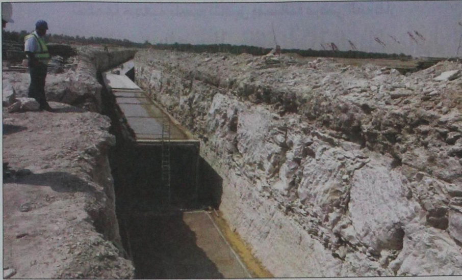
جانب من محطات معالجة مياه الصرف الصحي
