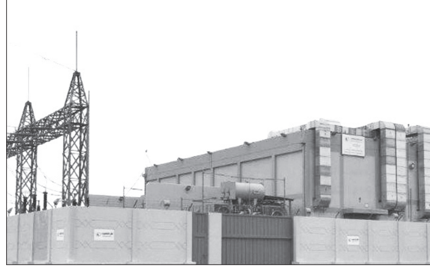
محطة التحويل جهد ١١٠/٣٨٠ كيلو فولت
